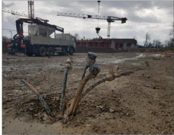
Ces tuyaux plongent sous terre pour aller récupérer les calories et les ramener à la surface, où elles alimenteront les bâtiments via un réseau de 2,4 kilomètres. Photo Le DL/M.R.
